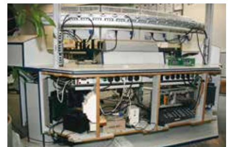
Mehr Technik als vermutet. Vor dem Umbau und der damit verbundenen Optimierung verbargen sich meterlange Kabelstränge in den Arbeitsplätzen.
